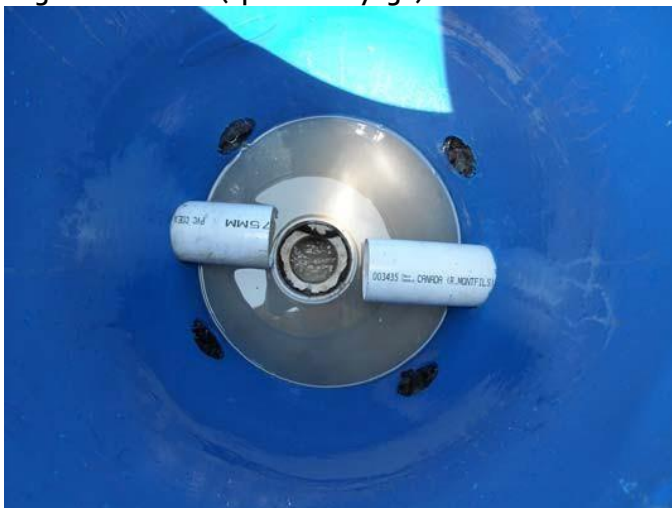
Regard de collecte (après nettoyage)
